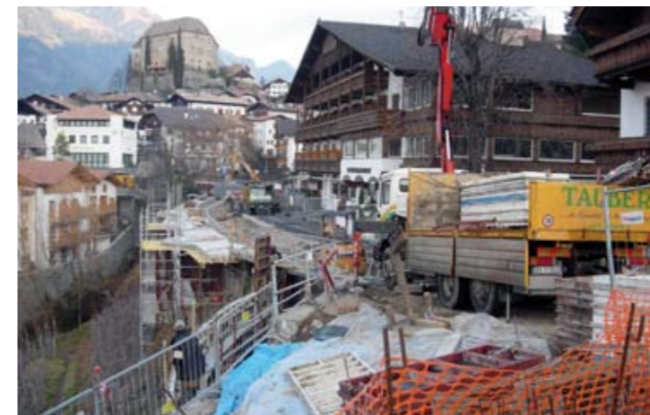
Das Ortszentrum von Schenna zwischen dem Moar Bild und der Dorfbrücke während der Bauzeit im Winter 2006/07 ...
